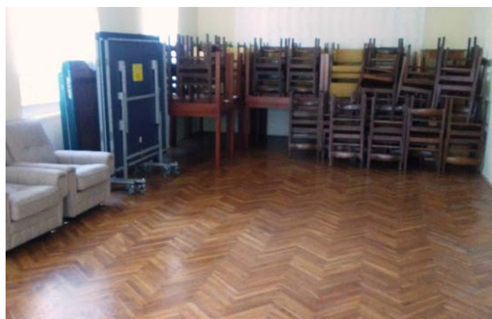
Sál na obecním úřadě potřebuje generální rekonstrukci.
